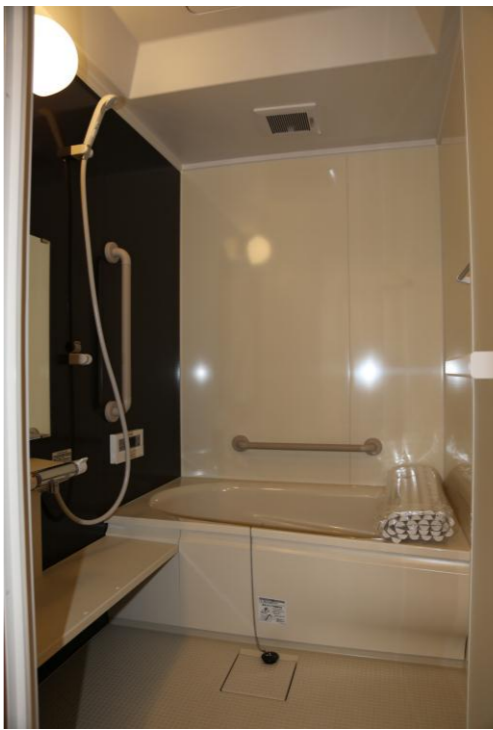
▲ 自動お湯張り装置の付いたユニットバス
