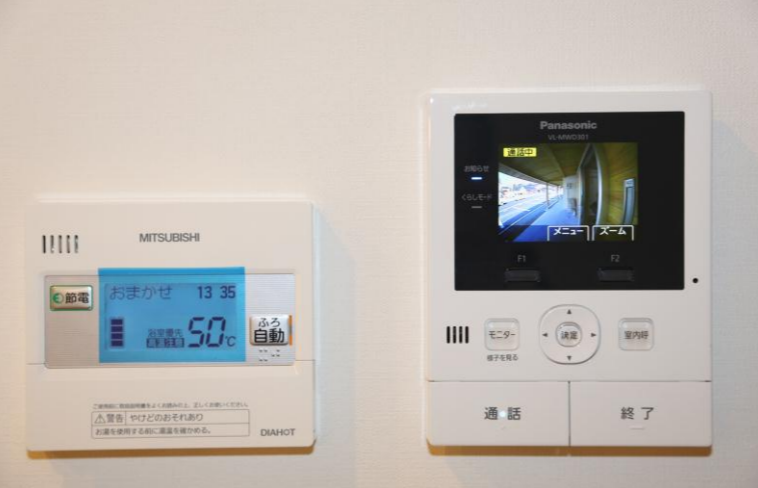
▲ 安全に配慮し、テレビ付ドアホンと自動お湯張り装置を設置
