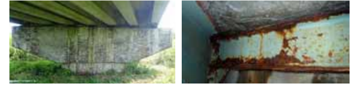
コンクリート橋のひび割れ 鋼材の腐食 (対象橋梁の対策を要する損傷例)
