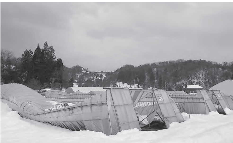
雪害で倒壊したハウス
