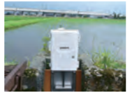
ICT自動給水栓等の設置
