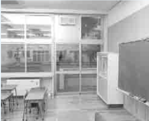
空調機が設置された教室
