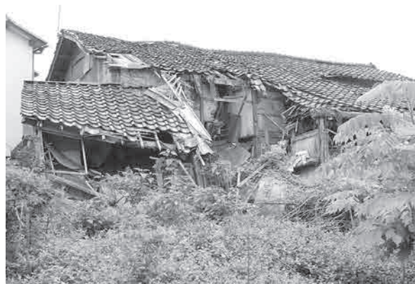
▲極めて危険な空き家（解体前）
