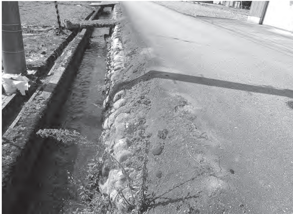
危険な用水路
