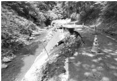
大岩・上浅生線災害現場
