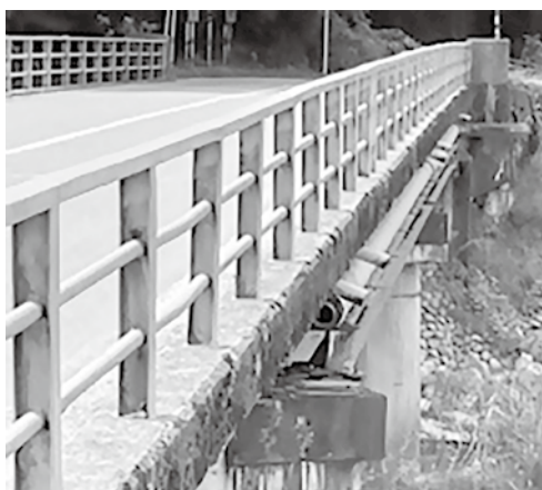
釈泉寺橋の老朽管
