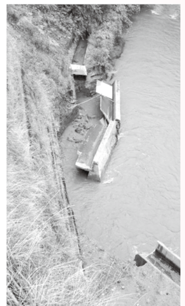
五ヶ用水の崩壊現場
