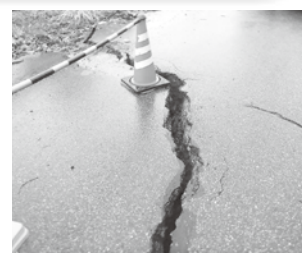
能登半島地震による地割れ
