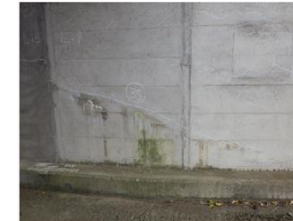
覆工のひび割れ
