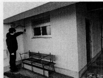
05-3 相ノ木小学校グラウンド キーボックス (屋外トイレ用)
