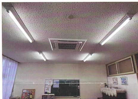
上市児童館2階相談室に 空調設備がなく 設置していただいた
